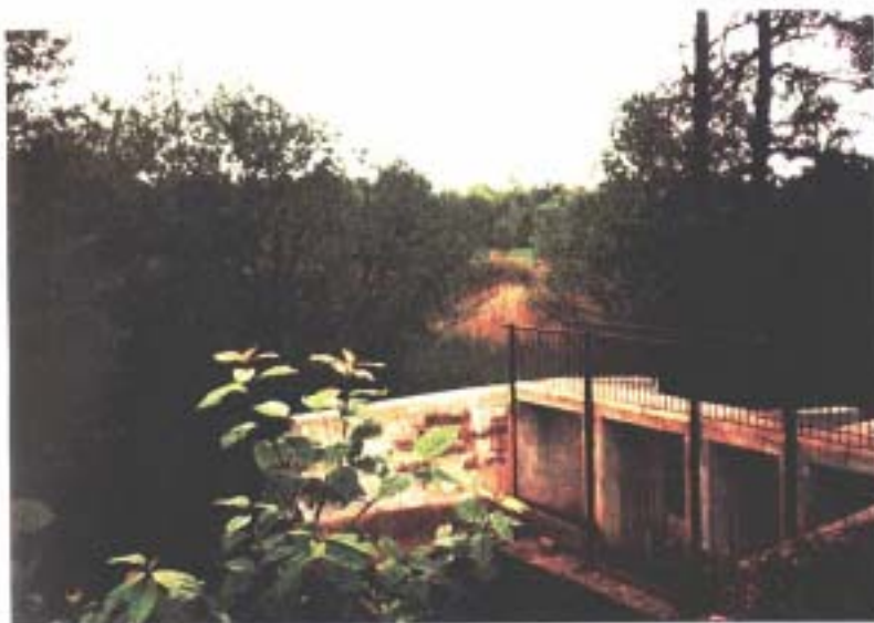
Istniejący odbudowany (nowy jaz na rz. Kamieniczce przy Ośrodku Rekreacji (baseny) w kamienicy Polskiej. W tle lewa dolina rzeki planowana pod zalew
