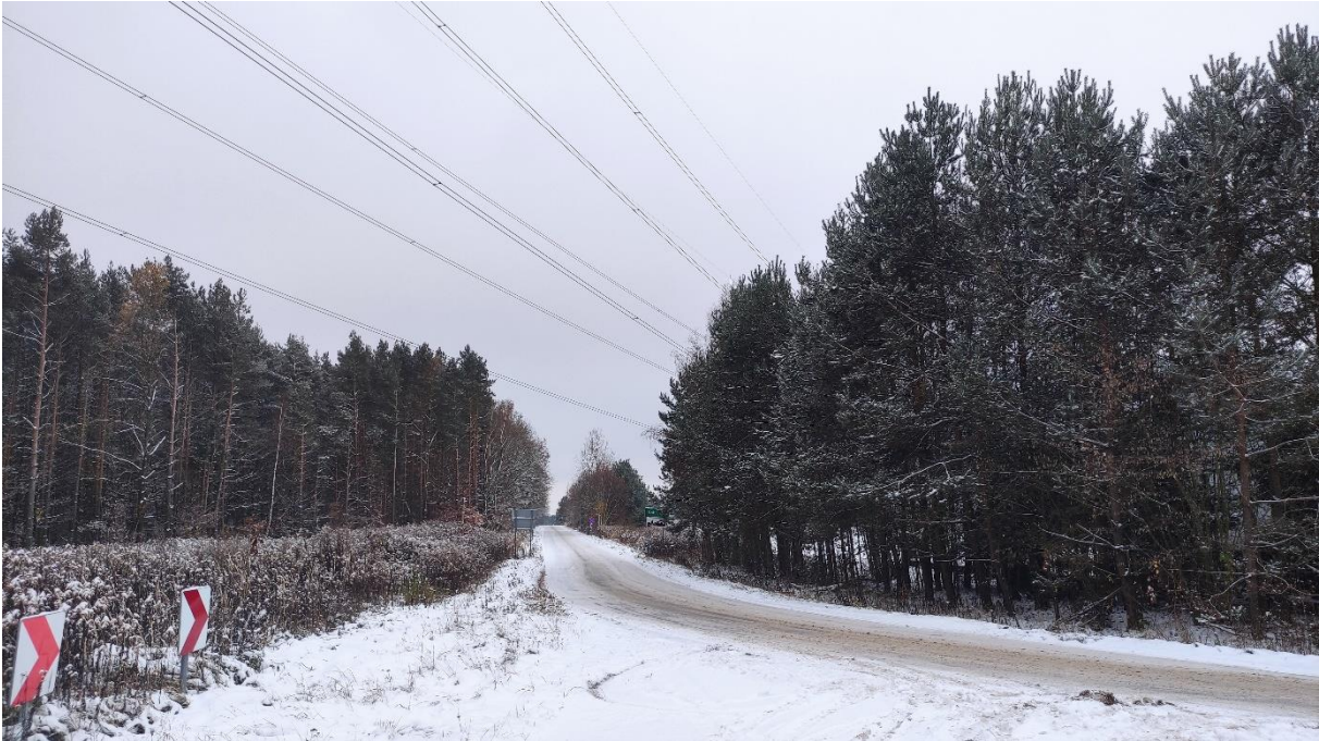
Zdjęcie nr 29. Dwutorowa Napowietrzna Linia Elektroenergetyczna 400 kV relacji Dobrzeń - Trębaczew i Trębaczew - Joachimów – widok fragmentu obiektu.
