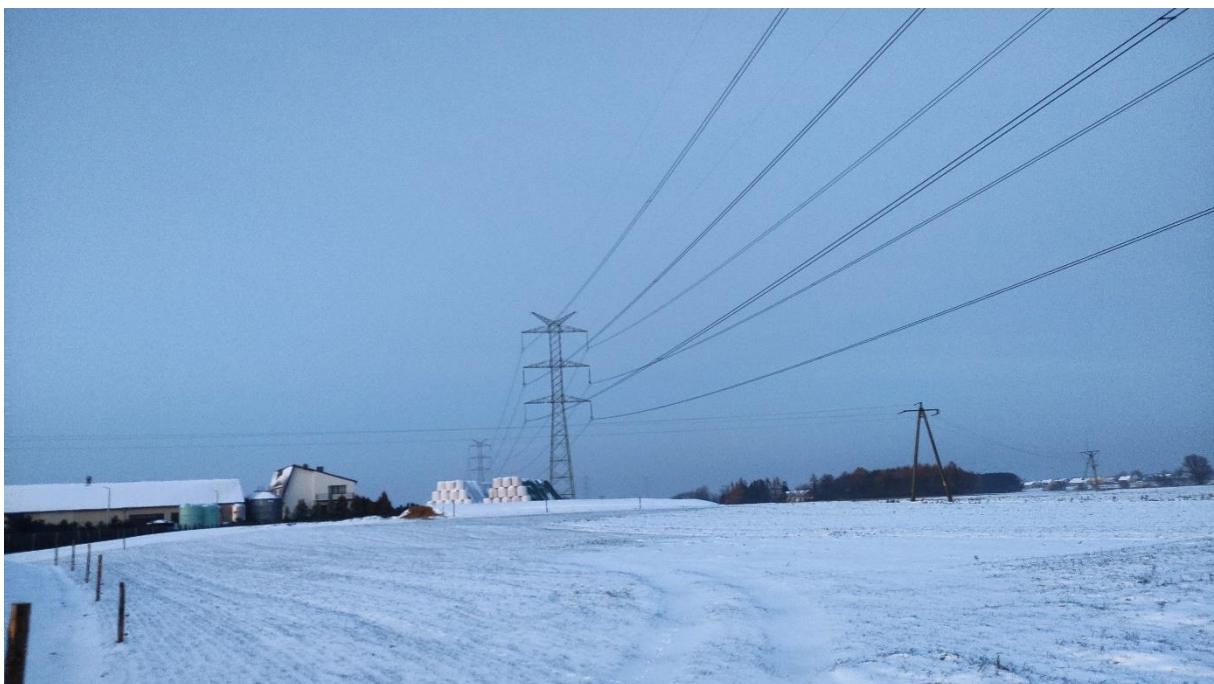
Zdjęcie nr 54. Dwutorowa Napowietrzna Linia Elektroenergetyczna 400 kV relacji Dobrzeń - Trębaczew i Trębaczew - Joachimów – widok fragmentu obiektu.
