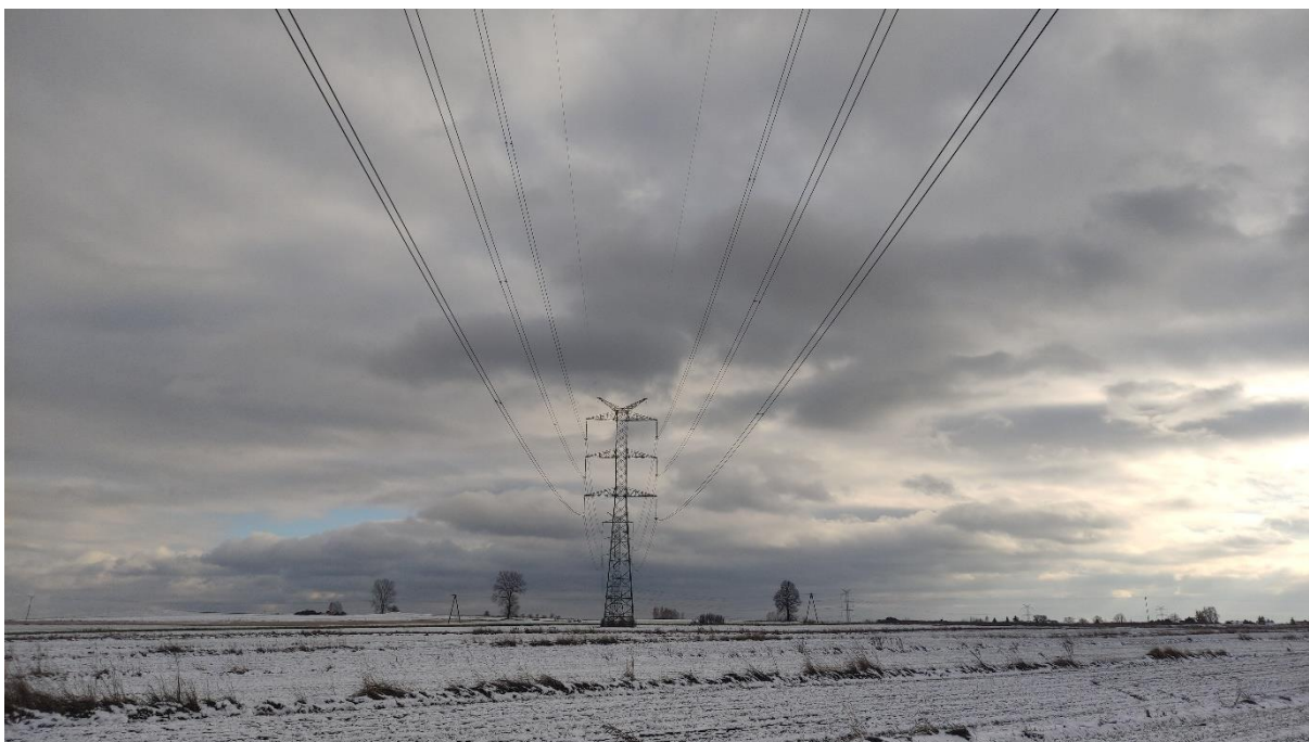
Zdjęcie nr 9. Dwutorowa Napowietrzna Linia Elektroenergetyczna 400 kV relacji Dobrzeń - Trębaczew i Trębaczew - Joachimów – widok fragmentu obiektu.
