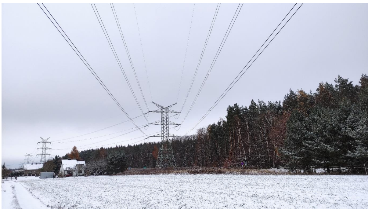
Zdjęcie nr 38. Dwutorowa Napowietrzna Linia Elektroenergetyczna 400 kV relacji Dobrzeń - Trębaczew i Trębaczew - Joachimów – widok fragmentu obiektu.
