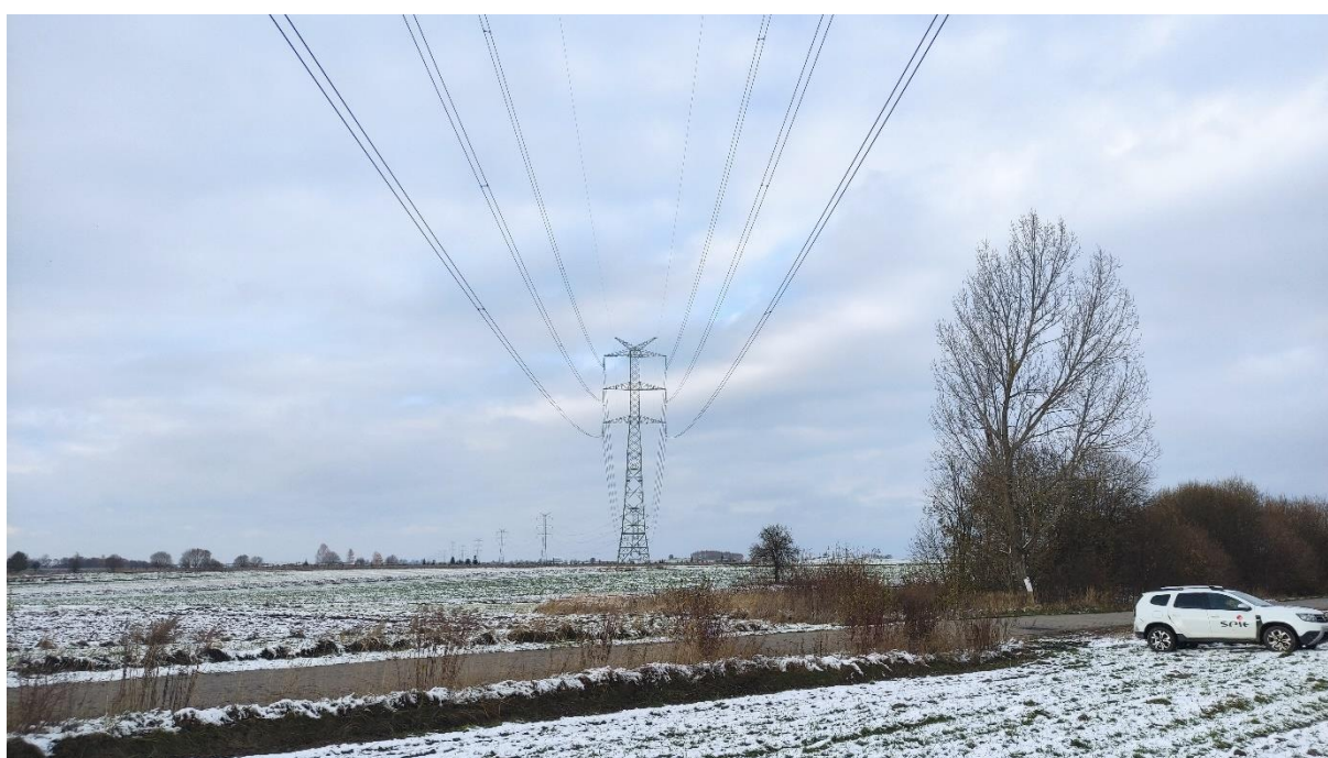
Zdjęcie nr 10. Dwutorowa Napowietrzna Linia Elektroenergetyczna 400 kV relacji Dobrzeń - Trębaczew i Trębaczew - Joachimów – widok fragmentu obiektu.
