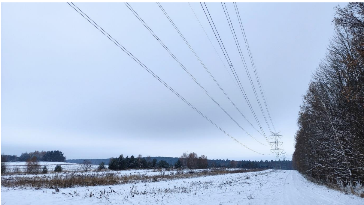
Zdjęcie nr 32. Dwutorowa Napowietrzna Linia Elektroenergetyczna 400 kV relacji Dobrzeń - Trębaczew i Trębaczew - Joachimów – widok fragmentu obiektu.
