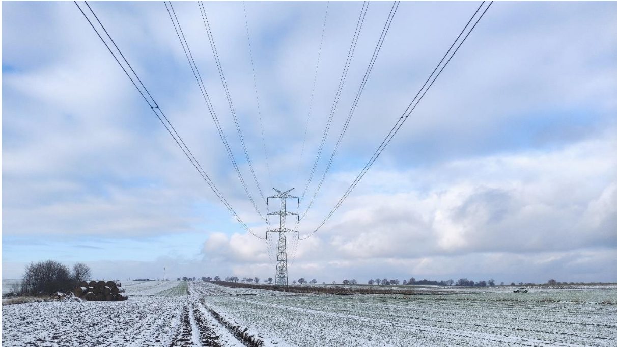
Zdjęcie nr 7. Dwutorowa Napowietrzna Linia Elektroenergetyczna 400 kV relacji Dobrzeń - Trębaczew i Trębaczew - Joachimów – widok fragmentu obiektu.
