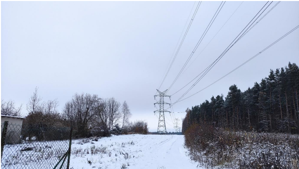
Zdjęcie nr 31. Dwutorowa Napowietrzna Linia Elektroenergetyczna 400 kV relacji Dobrzeń - Trębaczew i Trębaczew - Joachimów – widok fragmentu obiektu.
