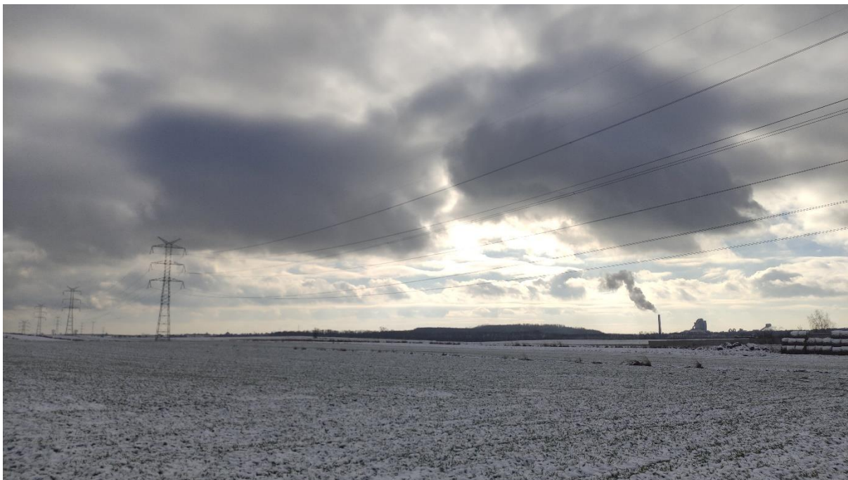
Zdjęcie nr 5. Dwutorowa Napowietrzna Linia Elektroenergetyczna 400 kV relacji Dobrzeń - Trębaczew i Trębaczew - Joachimów – widok fragmentu obiektu.
