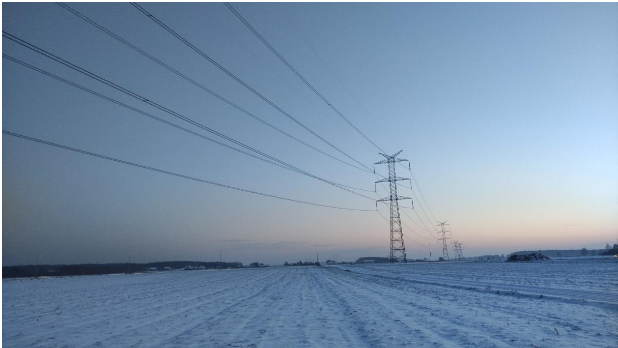
Zdjęcie nr 53. Dwutorowa Napowietrzna Linia Elektroenergetyczna 400 kV relacji Dobrzeń - Trębaczew i Trębaczew - Joachimów – widok fragmentu obiektu.
