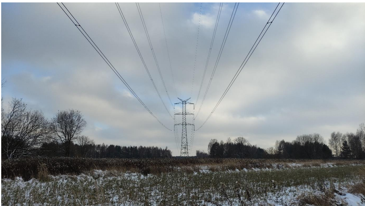
Zdjęcie nr 48. Dwutorowa Napowietrzna Linia Elektroenergetyczna 400 kV relacji Dobrzeń - Trębaczew i Trębaczew - Joachimów – widok fragmentu obiektu.
