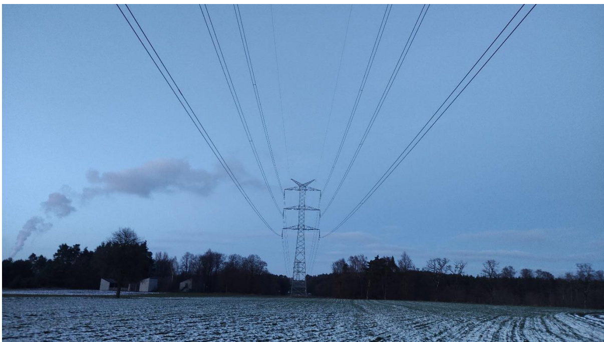
Zdjęcie nr 21. Dwutorowa Napowietrzna Linia Elektroenergetyczna 400 kV relacji Dobrzeń - Trębaczew i Trębaczew - Joachimów – widok fragmentu obiektu.
