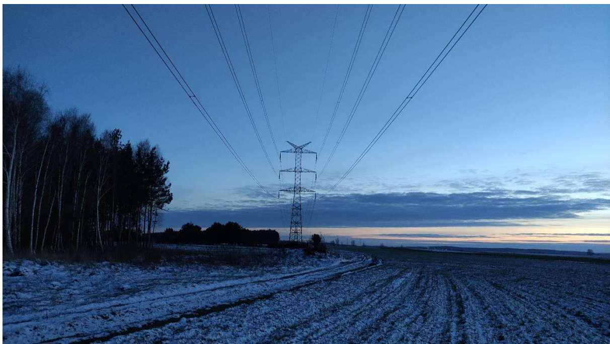
Zdjęcie nr 20. Dwutorowa Napowietrzna Linia Elektroenergetyczna 400 kV relacji Dobrzeń - Trębaczew i Trębaczew - Joachimów – widok fragmentu obiektu.
