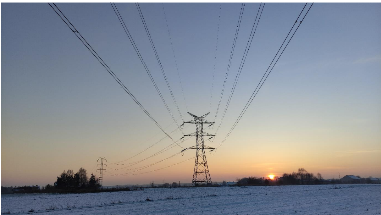
Zdjęcie nr 52. Dwutorowa Napowietrzna Linia Elektroenergetyczna 400 kV relacji Dobrzeń - Trębaczew i Trębaczew - Joachimów – widok fragmentu obiektu.
