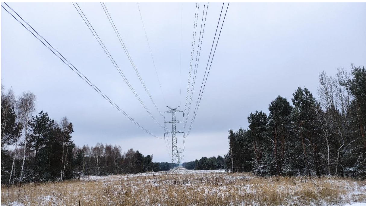
Zdjęcie nr 42. Dwutorowa Napowietrzna Linia Elektroenergetyczna 400 kV relacji Dobrzeń - Trębaczew i Trębaczew - Joachimów – widok fragmentu obiektu.
