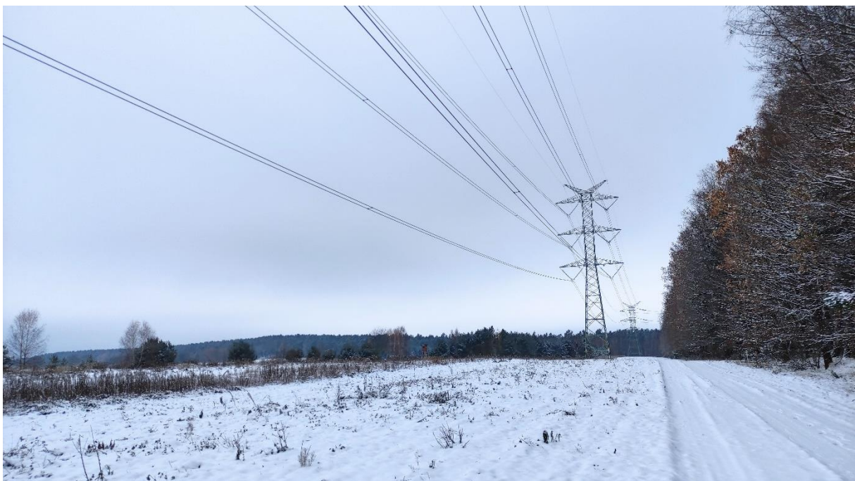
Zdjęcie nr 34. Dwutorowa Napowietrzna Linia Elektroenergetyczna 400 kV relacji Dobrzeń - Trębaczew i Trębaczew - Joachimów – widok fragmentu obiektu.
