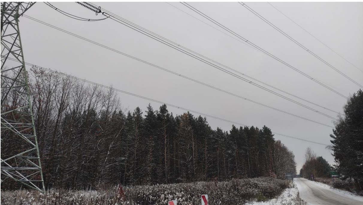
Zdjęcie nr 30. Dwutorowa Napowietrzna Linia Elektroenergetyczna 400 kV relacji Dobrzeń - Trębaczew i Trębaczew - Joachimów – widok fragmentu obiektu.
