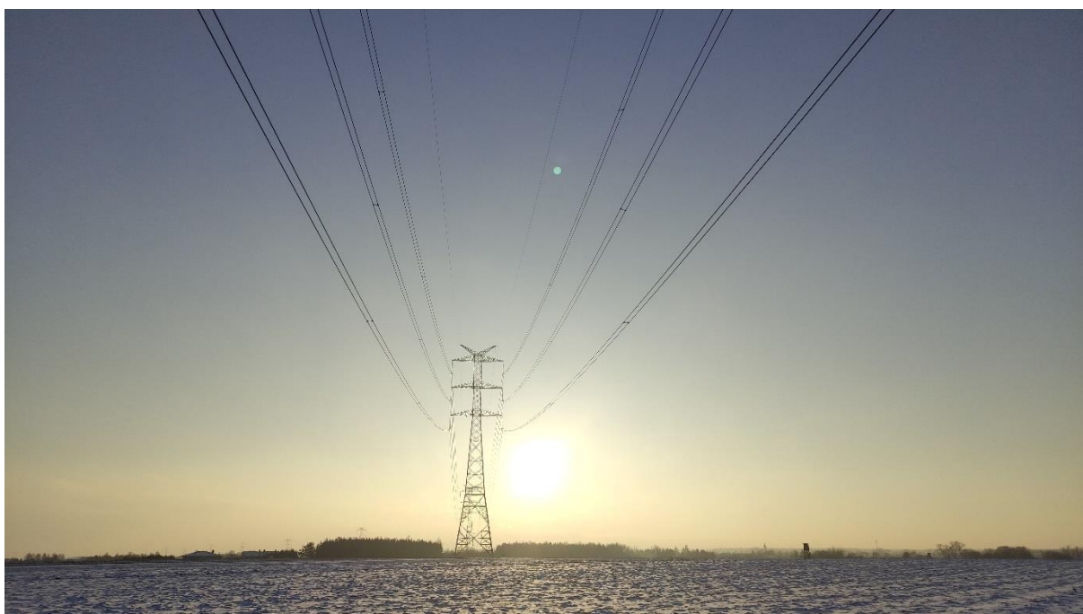
Zdjęcie nr 50. Dwutorowa Napowietrzna Linia Elektroenergetyczna 400 kV relacji Dobrzeń - Trębaczew i Trębaczew - Joachimów – widok fragmentu obiektu.
