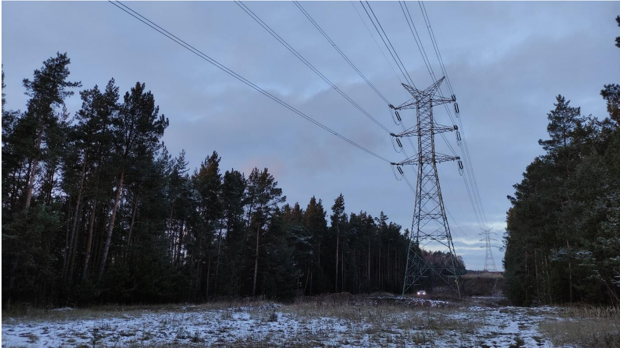
Zdjęcie nr 19. Dwutorowa Napowietrzna Linia Elektroenergetyczna 400 kV relacji Dobrzeń - Trębaczew i Trębaczew - Joachimów – widok fragmentu obiektu.
