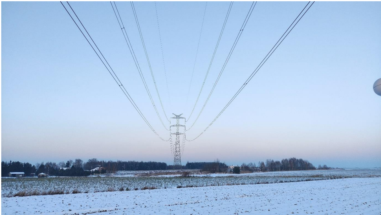
Zdjęcie nr 51. Dwutorowa Napowietrzna Linia Elektroenergetyczna 400 kV relacji Dobrzeń - Trębaczew i Trębaczew - Joachimów – widok fragmentu obiektu.
