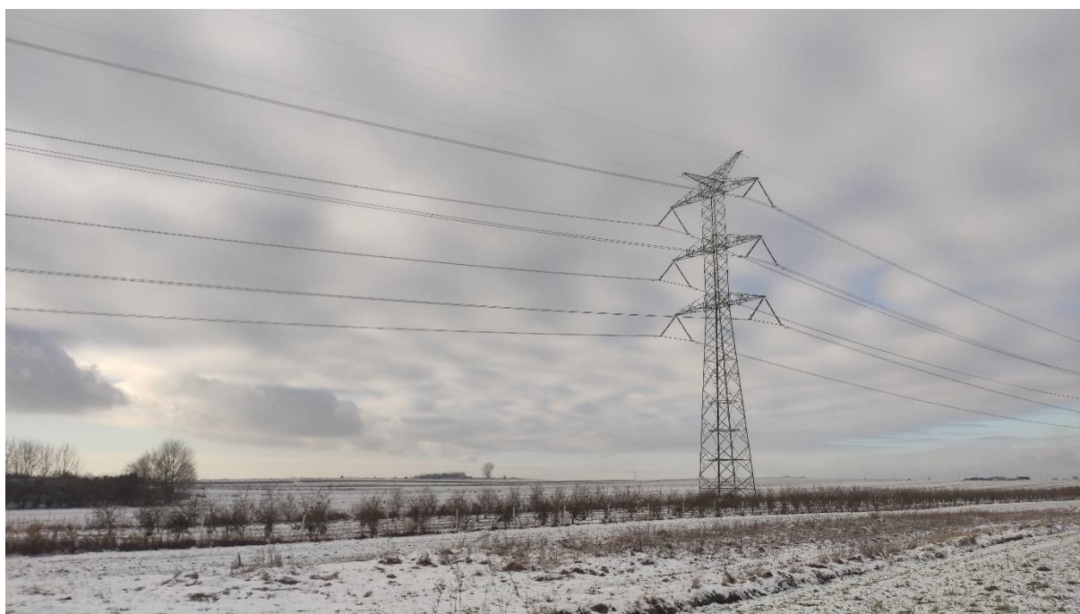
Zdjęcie nr 6. Dwutorowa Napowietrzna Linia Elektroenergetyczna 400 kV relacji Dobrzeń - Trębaczew i Trębaczew - Joachimów – widok fragmentu obiektu.
