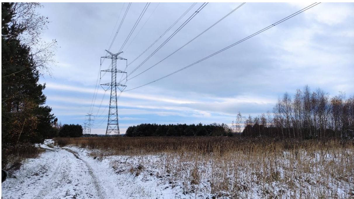
Zdjęcie nr 14. Dwutorowa Napowietrzna Linia Elektroenergetyczna 400 kV relacji Dobrzeń - Trębaczew i Trębaczew - Joachimów – widok fragmentu obiektu.
