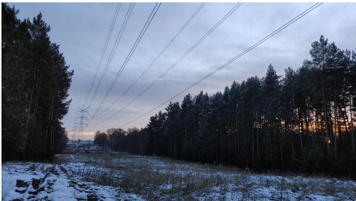
Zdjęcie nr 18. Dwutorowa Napowietrzna Linia Elektroenergetyczna 400 kV relacji Dobrzeń - Trębaczew i Trębaczew - Joachimów – widok fragmentu obiektu.
