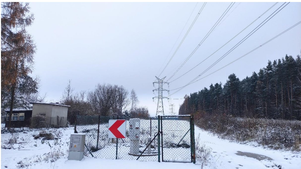
Zdjęcie nr 28. Dwutorowa Napowietrzna Linia Elektroenergetyczna 400 kV relacji Dobrzeń - Trębaczew i Trębaczew - Joachimów – widok fragmentu obiektu.
