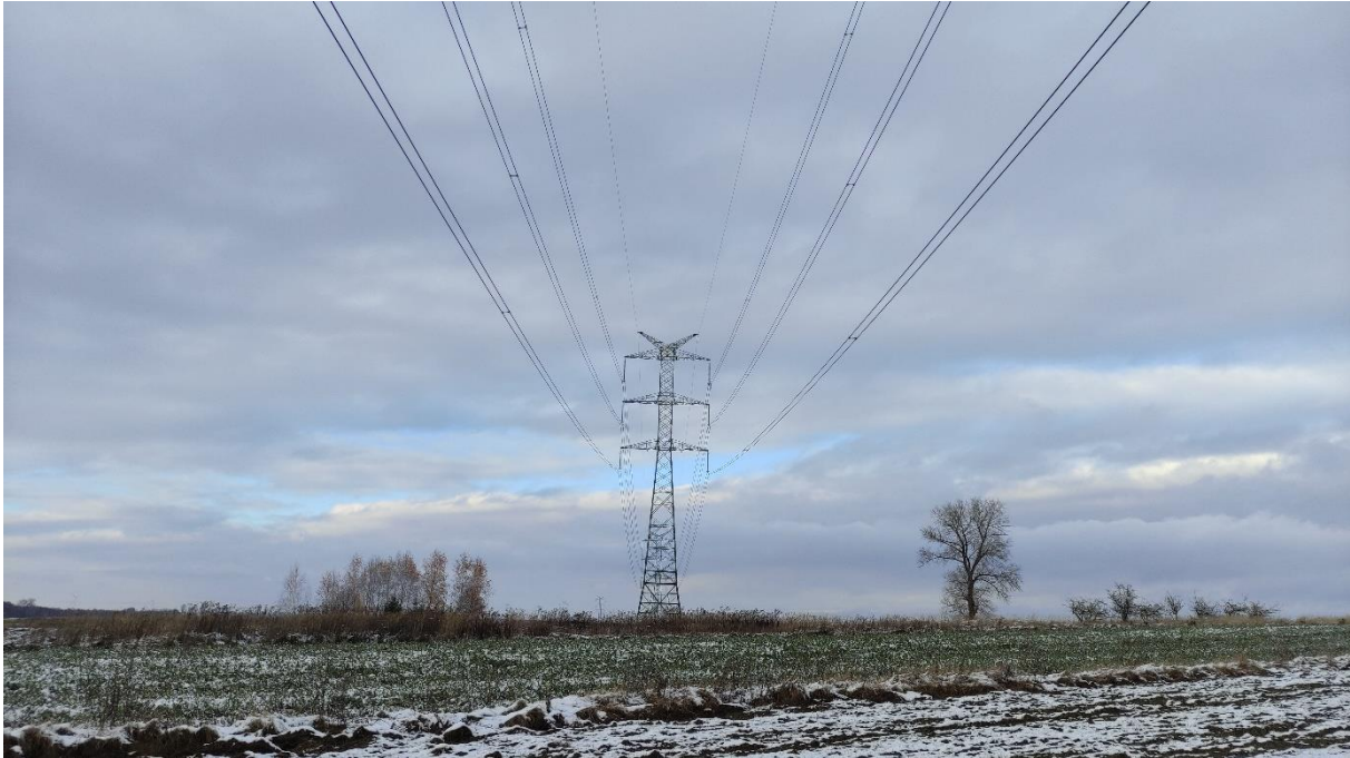
Zdjęcie nr 11. Dwutorowa Napowietrzna Linia Elektroenergetyczna 400 kV relacji Dobrzeń - Trębaczew i Trębaczew - Joachimów – widok fragmentu obiektu.
