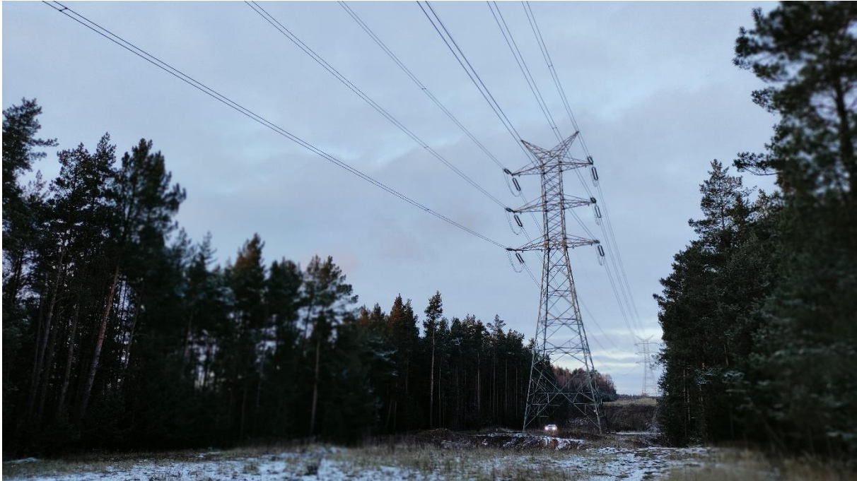
Zdjęcie nr 17. Dwutorowa Napowietrzna Linia Elektroenergetyczna 400 kV relacji Dobrzeń - Trębaczew i Trębaczew - Joachimów – widok fragmentu obiektu.
