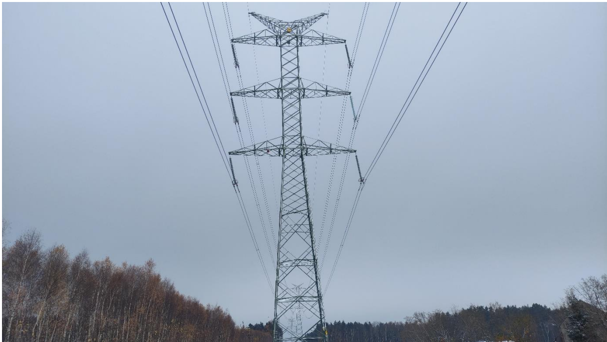
Zdjęcie nr 27. Dwutorowa Napowietrzna Linia Elektroenergetyczna 400 kV relacji Dobrzeń - Trębaczew i Trębaczew - Joachimów – widok fragmentu obiektu.
