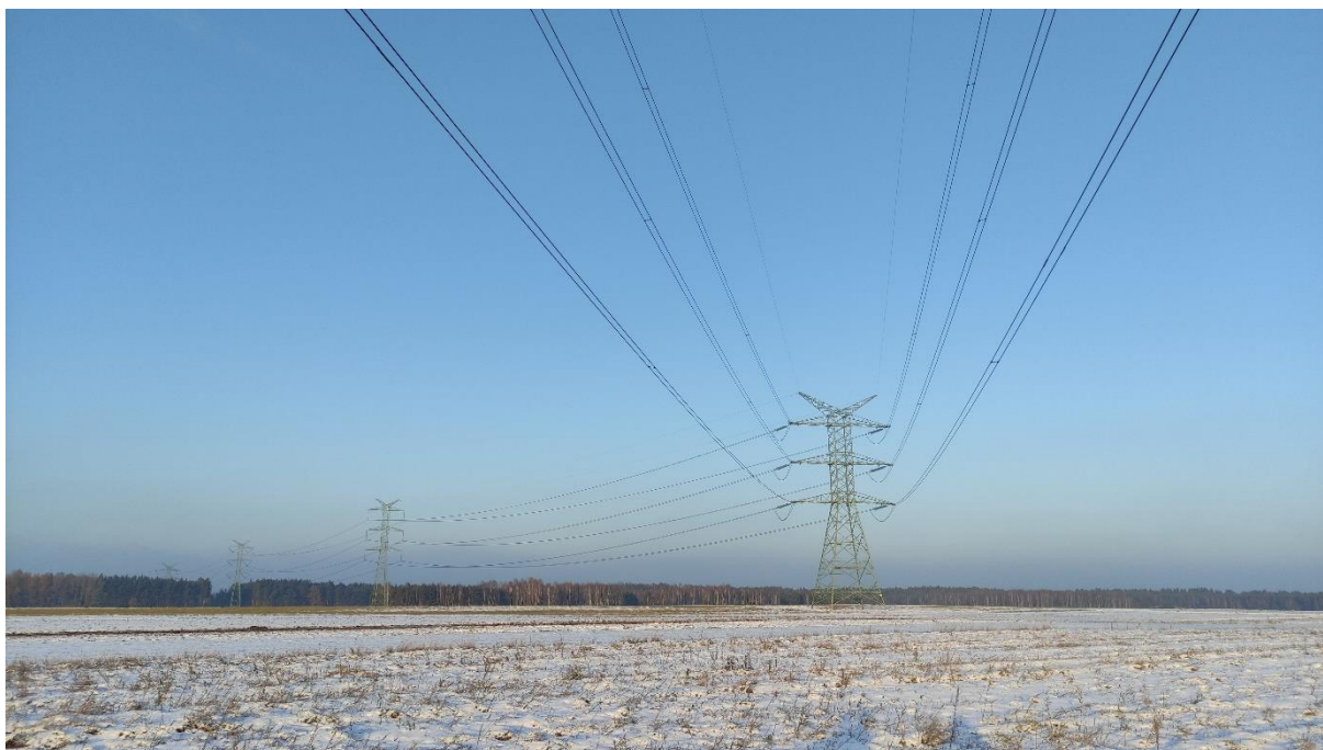
Zdjęcie nr 49. Dwutorowa Napowietrzna Linia Elektroenergetyczna 400 kV relacji Dobrzeń - Trębaczew i Trębaczew - Joachimów – widok fragmentu obiektu.
