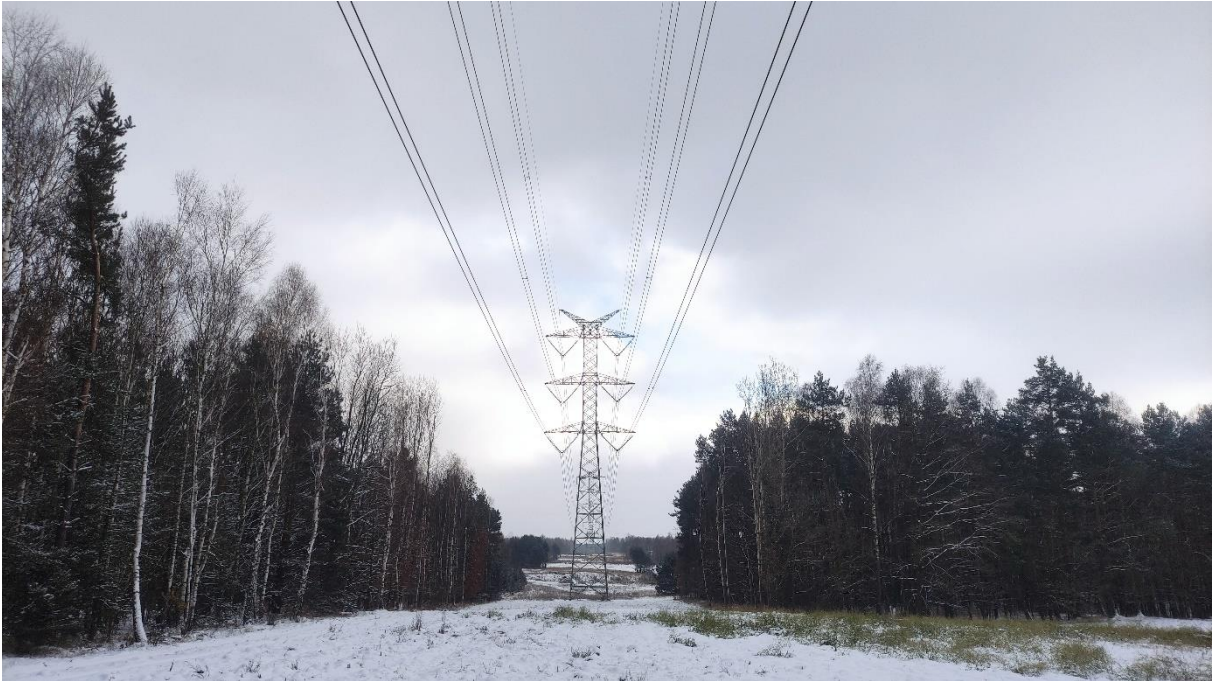
Zdjęcie nr 45. Dwutorowa Napowietrzna Linia Elektroenergetyczna 400 kV relacji Dobrzeń - Trębaczew i Trębaczew - Joachimów – widok fragmentu obiektu.
