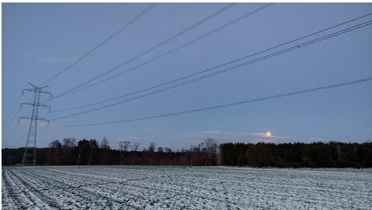
Zdjęcie nr 22. Dwutorowa Napowietrzna Linia Elektroenergetyczna 400 kV relacji Dobrzeń - Trębaczew i Trębaczew - Joachimów – widok fragmentu obiektu.
