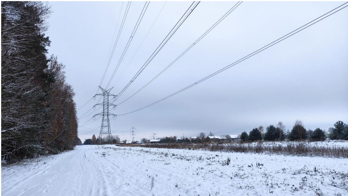
Zdjęcie nr 33. Dwutorowa Napowietrzna Linia Elektroenergetyczna 400 kV relacji Dobrzeń - Trębaczew i Trębaczew - Joachimów – widok fragmentu obiektu.
