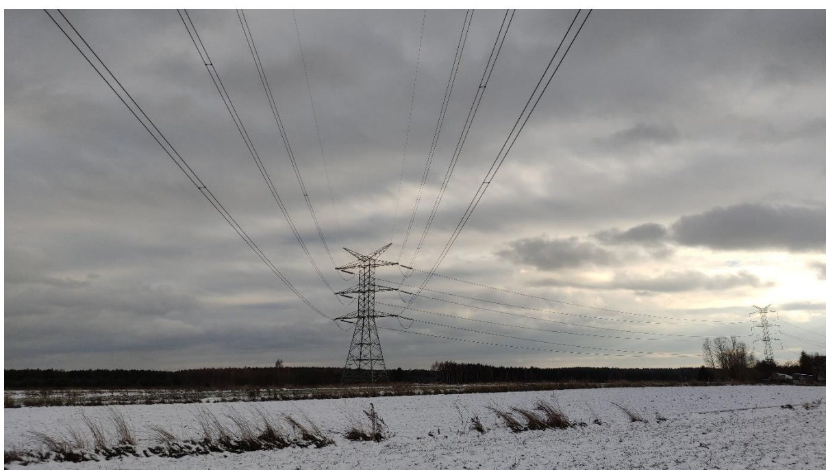
Zdjęcie nr 12. Dwutorowa Napowietrzna Linia Elektroenergetyczna 400 kV relacji Dobrzeń - Trębaczew i Trębaczew - Joachimów – widok fragmentu obiektu.
