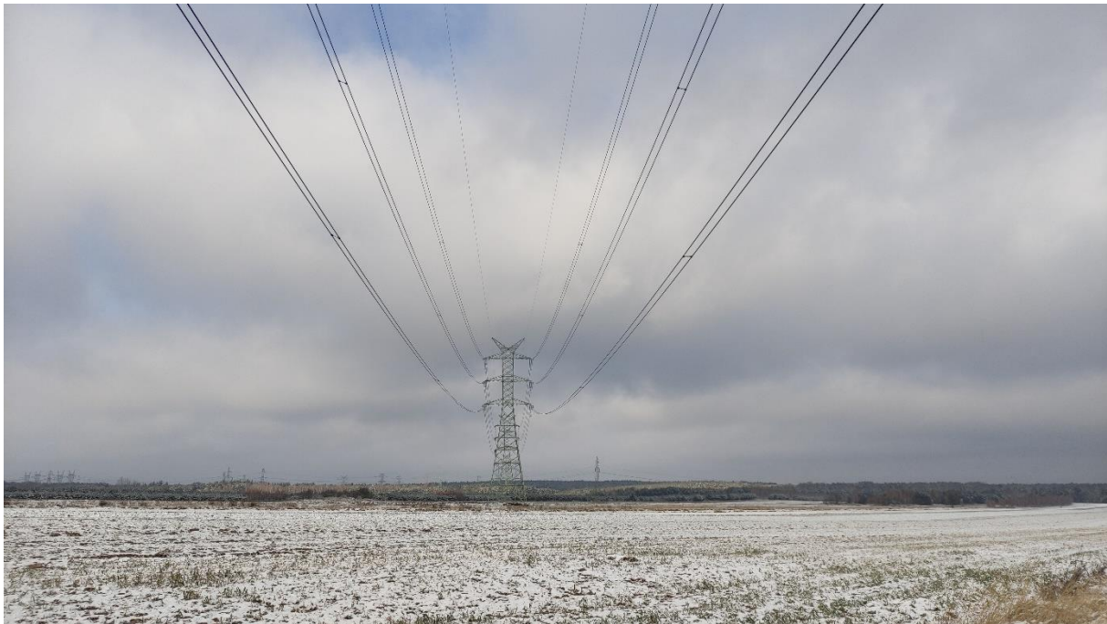
Zdjęcie nr 1. Dwutorowa Napowietrzna Linia Elektroenergetyczna 400 kV relacji Dobrzeń - Trębaczew i Trębaczew - Joachimów – widok fragmentu obiektu.
