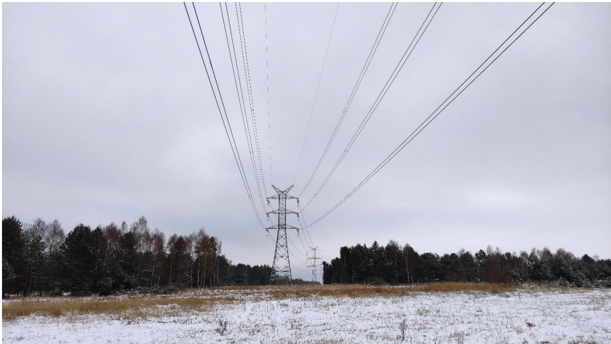
Zdjęcie nr 41. Dwutorowa Napowietrzna Linia Elektroenergetyczna 400 kV relacji Dobrzeń - Trębaczew i Trębaczew - Joachimów – widok fragmentu obiektu.
