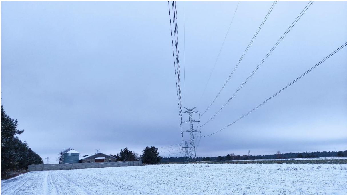
Zdjęcie nr 35. Dwutorowa Napowietrzna Linia Elektroenergetyczna 400 kV relacji Dobrzeń - Trębaczew i Trębaczew - Joachimów – widok fragmentu obiektu.
