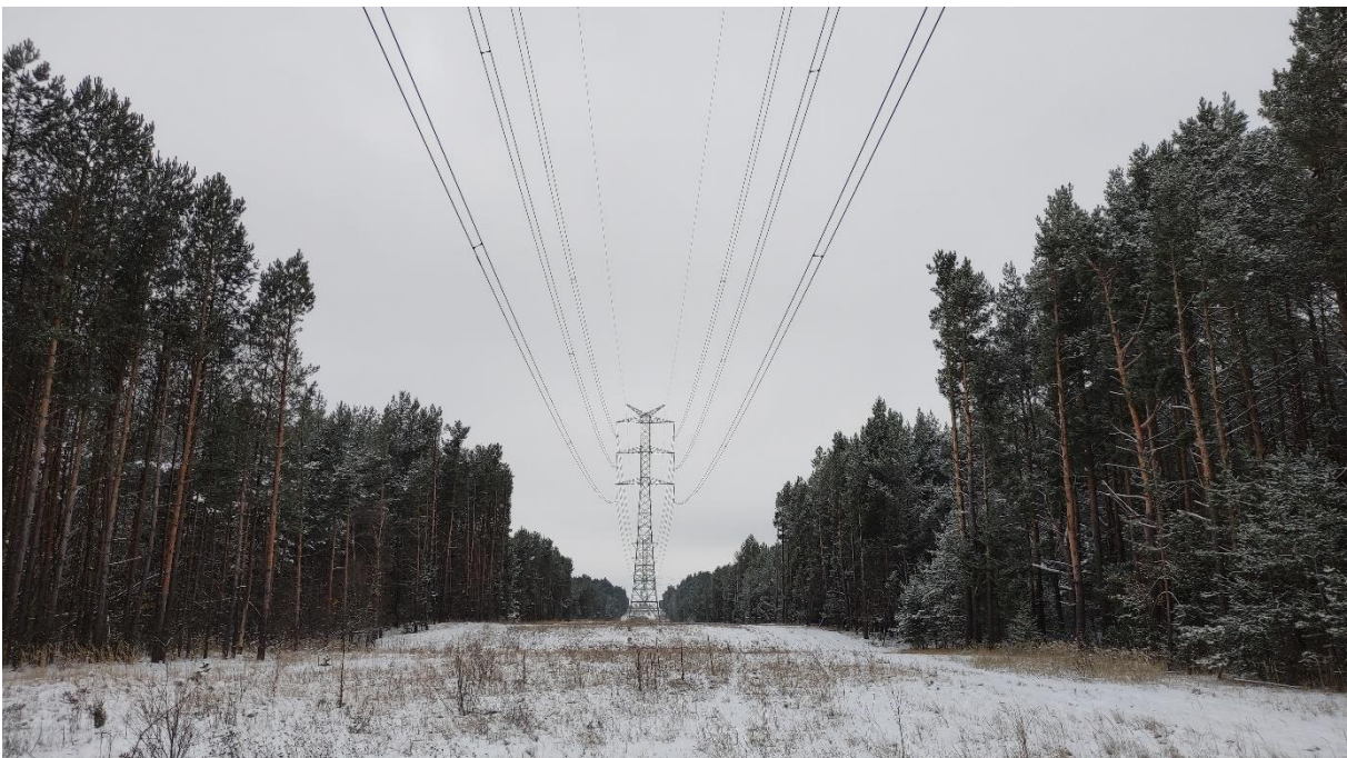
Zdjęcie nr 40. Dwutorowa Napowietrzna Linia Elektroenergetyczna 400 kV relacji Dobrzeń - Trębaczew i Trębaczew - Joachimów – widok fragmentu obiektu.
