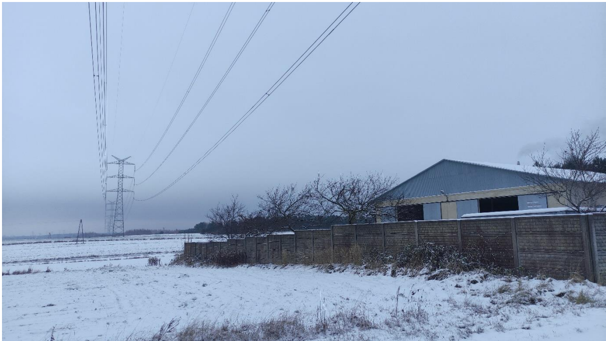
Zdjęcie nr 25. Dwutorowa Napowietrzna Linia Elektroenergetyczna 400 kV relacji Dobrzeń - Trębaczew i Trębaczew - Joachimów – widok fragmentu obiektu.
