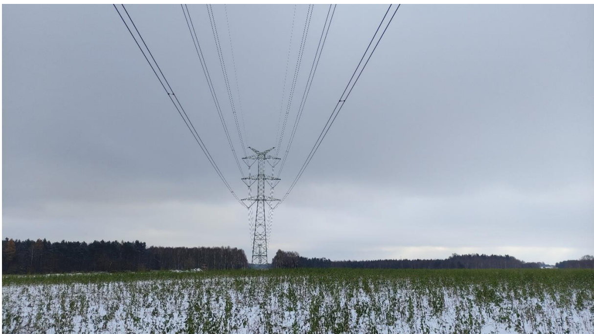
Zdjęcie nr 44. Dwutorowa Napowietrzna Linia Elektroenergetyczna 400 kV relacji Dobrzeń - Trębaczew i Trębaczew - Joachimów – widok fragmentu obiektu.
