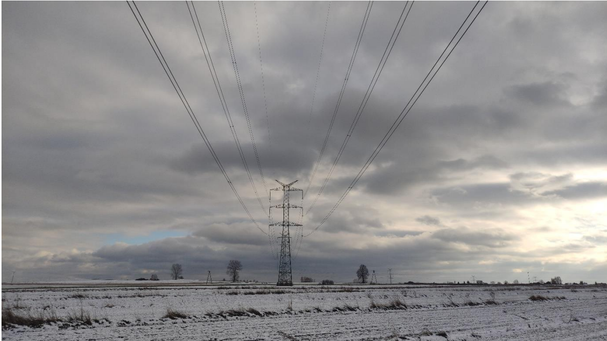
Zdjęcie nr 9. Dwutorowa Napowietrzna Linia Elektroenergetyczna 400 kV relacji Dobrzeń - Trębaczew i Trębaczew - Joachimów – widok fragmentu obiektu.
