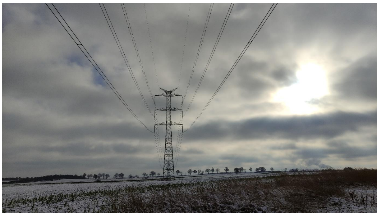
Zdjęcie nr 2. Dwutorowa Napowietrzna Linia Elektroenergetyczna 400 kV relacji Dobrzeń - Trębaczew i Trębaczew - Joachimów – widok fragmentu obiektu.
