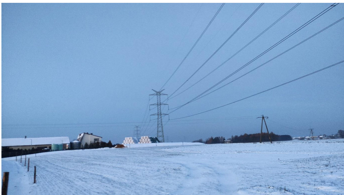
Zdjęcie nr 54. Dwutorowa Napowietrzna Linia Elektroenergetyczna 400 kV relacji Dobrzeń - Trębaczew i Trębaczew - Joachimów – widok fragmentu obiektu.
