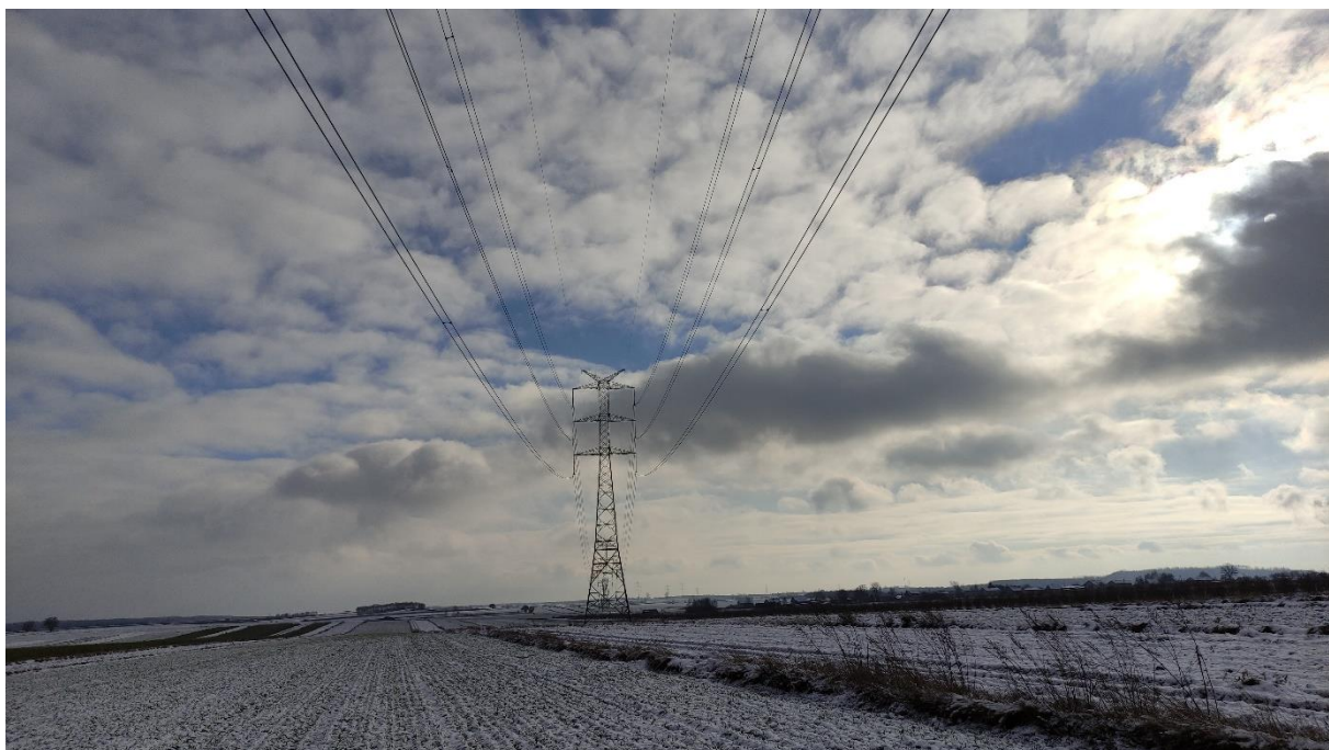
Zdjęcie nr 4. Dwutorowa Napowietrzna Linia Elektroenergetyczna 400 kV relacji Dobrzeń - Trębaczew i Trębaczew - Joachimów – widok fragmentu obiektu.
