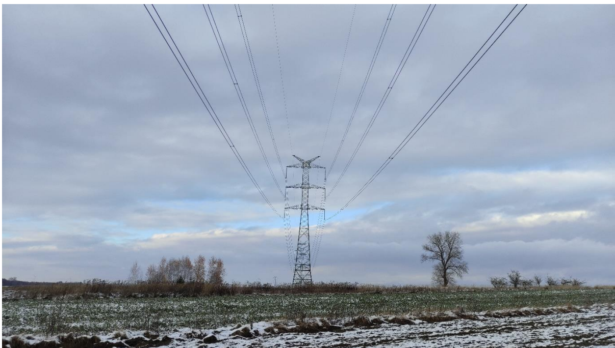
Zdjęcie nr 11. Dwutorowa Napowietrzna Linia Elektroenergetyczna 400 kV relacji Dobrzeń - Trębaczew i Trębaczew - Joachimów – widok fragmentu obiektu.
