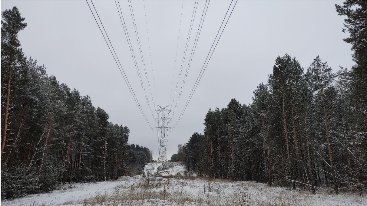
Zdjęcie nr 39. Dwutorowa Napowietrzna Linia Elektroenergetyczna 400 kV relacji Dobrzeń - Trębaczew i Trębaczew - Joachimów – widok fragmentu obiektu.
