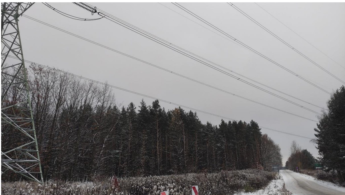
Zdjęcie nr 30. Dwutorowa Napowietrzna Linia Elektroenergetyczna 400 kV relacji Dobrzeń - Trębaczew i Trębaczew - Joachimów – widok fragmentu obiektu.
