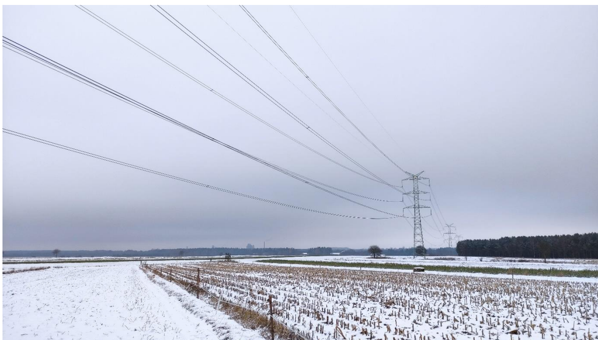
Zdjęcie nr 24. Dwutorowa Napowietrzna Linia Elektroenergetyczna 400 kV relacji Dobrzeń - Trębaczew i Trębaczew - Joachimów – widok fragmentu obiektu.
