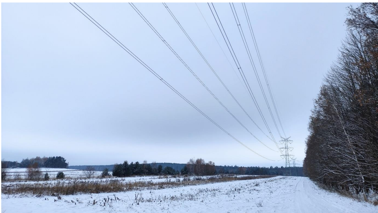
Zdjęcie nr 32. Dwutorowa Napowietrzna Linia Elektroenergetyczna 400 kV relacji Dobrzeń - Trębaczew i Trębaczew - Joachimów – widok fragmentu obiektu.
