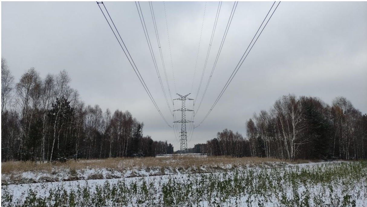
Zdjęcie nr 43. Dwutorowa Napowietrzna Linia Elektroenergetyczna 400 kV relacji Dobrzeń - Trębaczew i Trębaczew - Joachimów – widok fragmentu obiektu.
