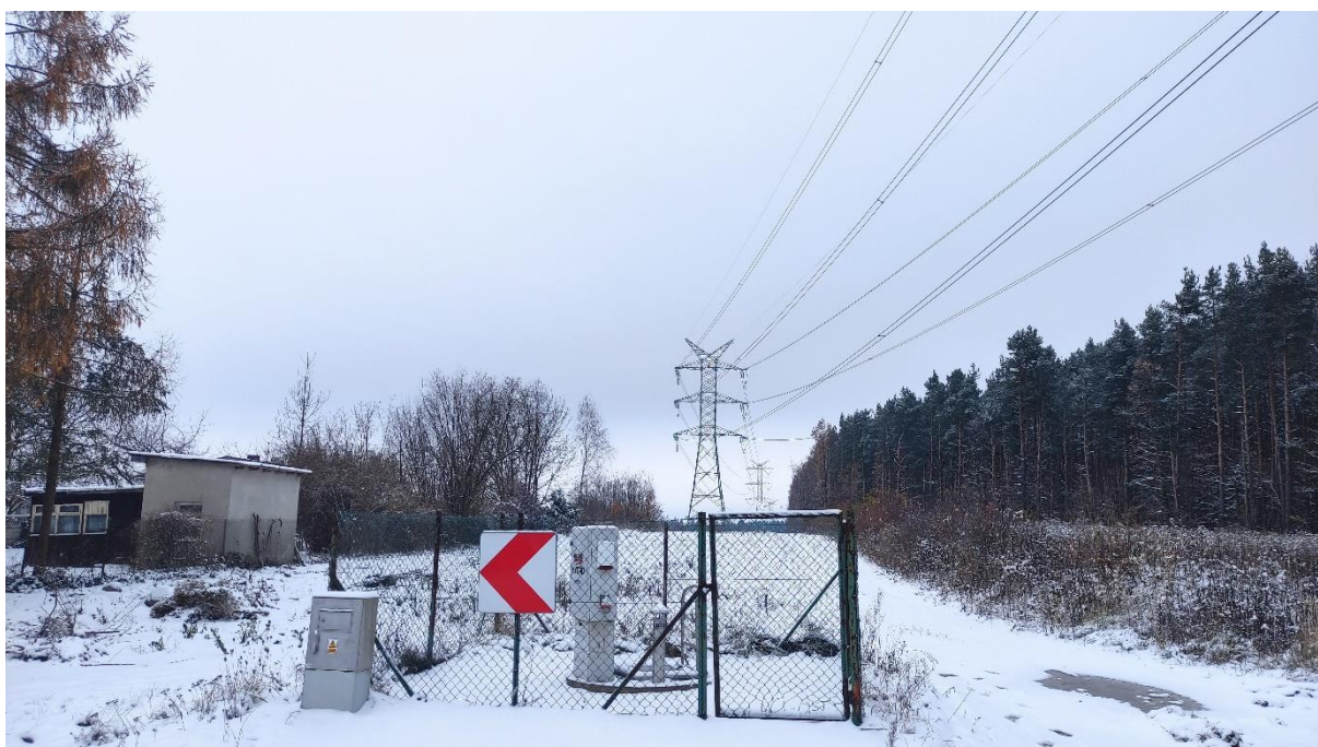
Zdjęcie nr 28. Dwutorowa Napowietrzna Linia Elektroenergetyczna 400 kV relacji Dobrzeń - Trębaczew i Trębaczew - Joachimów – widok fragmentu obiektu.
