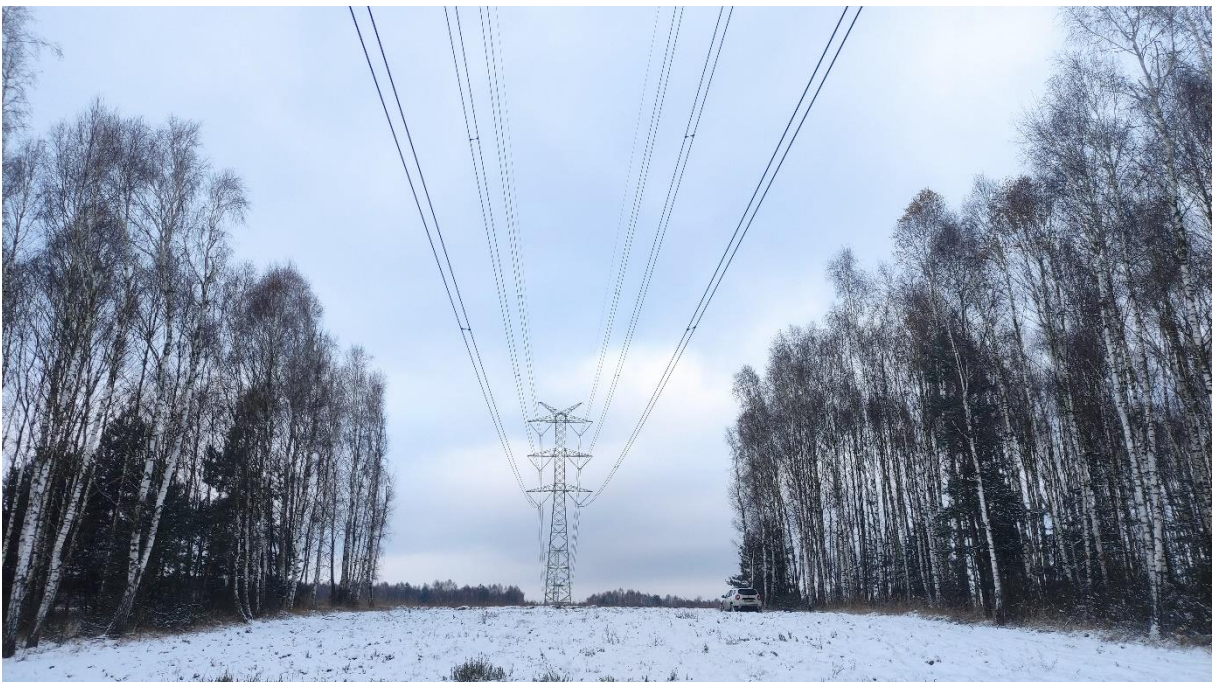
Zdjęcie nr 46. Dwutorowa Napowietrzna Linia Elektroenergetyczna 400 kV relacji Dobrzeń - Trębaczew i Trębaczew - Joachimów – widok fragmentu obiektu.
