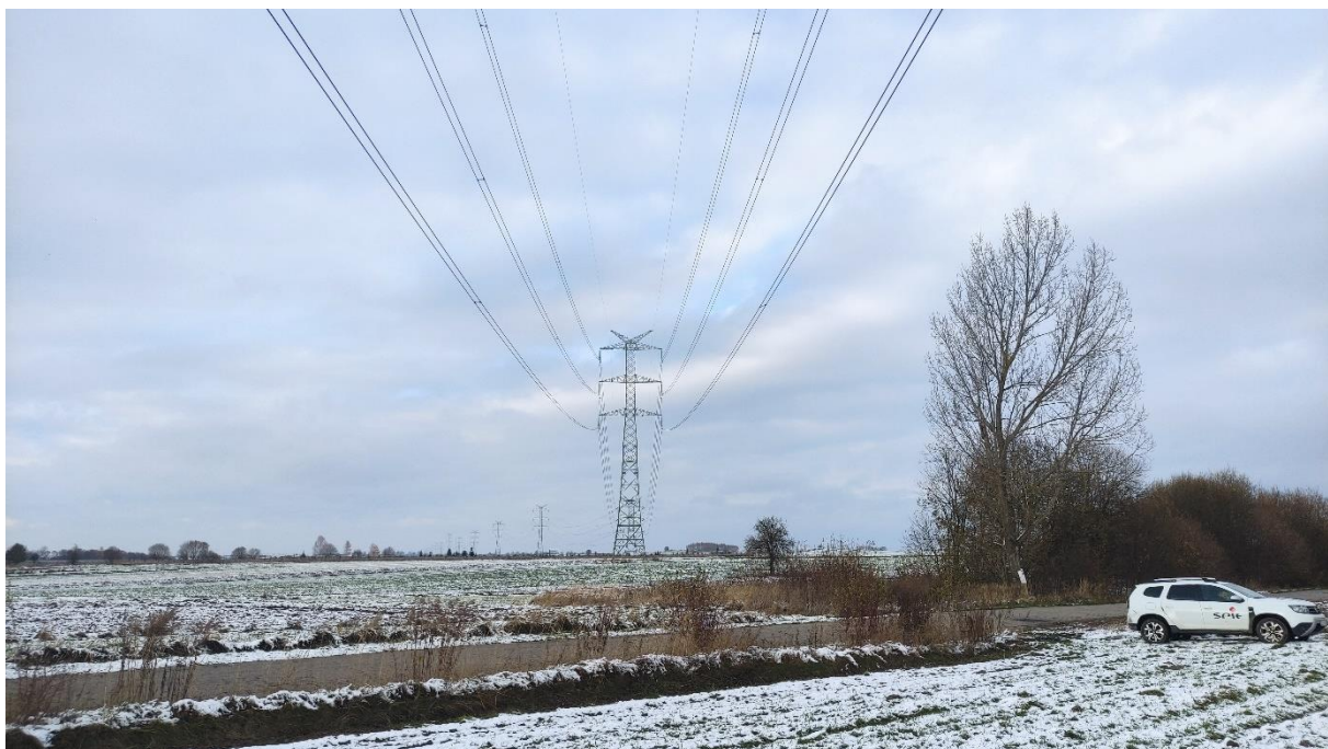
Zdjęcie nr 10. Dwutorowa Napowietrzna Linia Elektroenergetyczna 400 kV relacji Dobrzeń - Trębaczew i Trębaczew - Joachimów – widok fragmentu obiektu.
