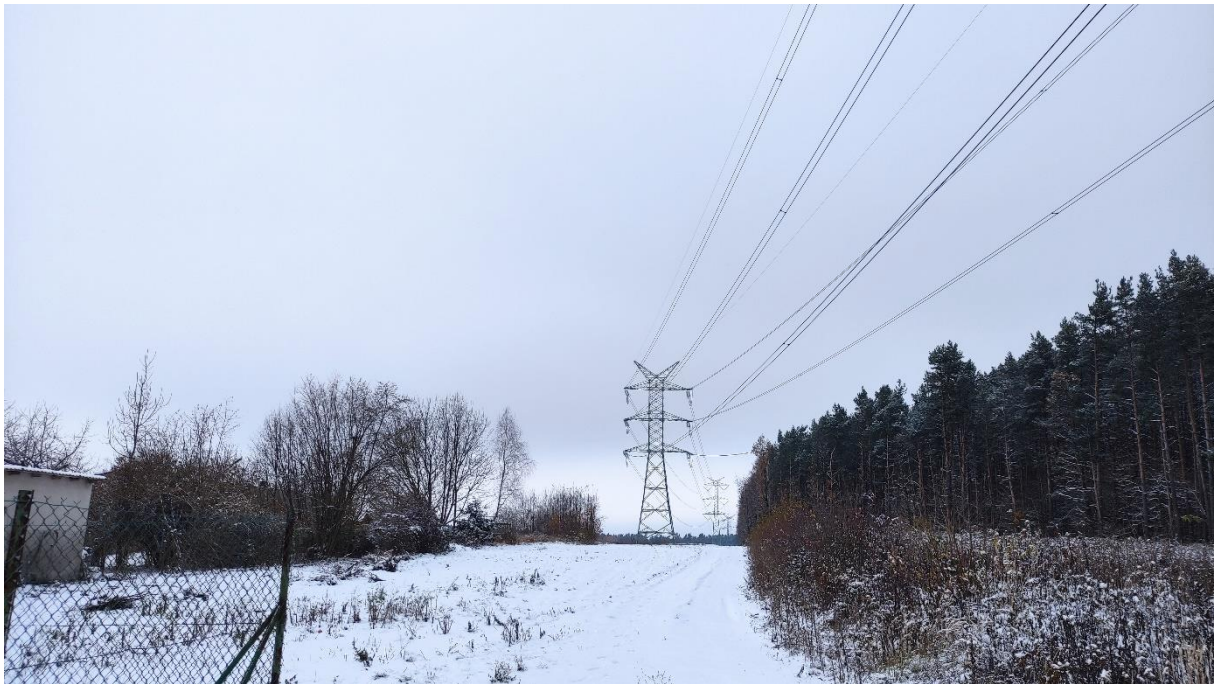
Zdjęcie nr 31. Dwutorowa Napowietrzna Linia Elektroenergetyczna 400 kV relacji Dobrzeń - Trębaczew i Trębaczew - Joachimów – widok fragmentu obiektu.
