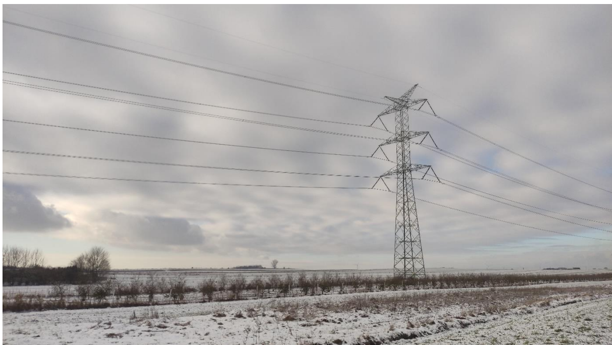
Zdjęcie nr 6. Dwutorowa Napowietrzna Linia Elektroenergetyczna 400 kV relacji Dobrzeń - Trębaczew i Trębaczew - Joachimów – widok fragmentu obiektu.
