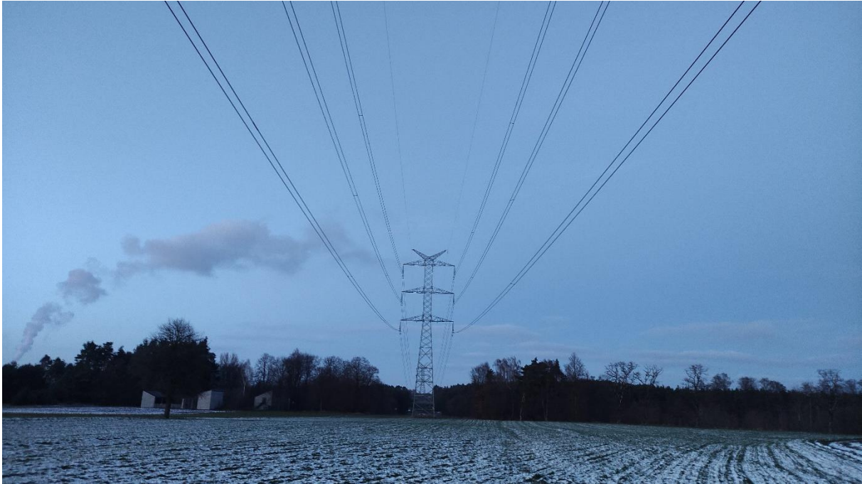
Zdjęcie nr 21. Dwutorowa Napowietrzna Linia Elektroenergetyczna 400 kV relacji Dobrzeń - Trębaczew i Trębaczew - Joachimów – widok fragmentu obiektu.
