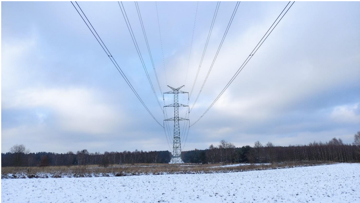
Zdjęcie nr 47. Dwutorowa Napowietrzna Linia Elektroenergetyczna 400 kV relacji Dobrzeń - Trębaczew i Trębaczew - Joachimów – widok fragmentu obiektu.
