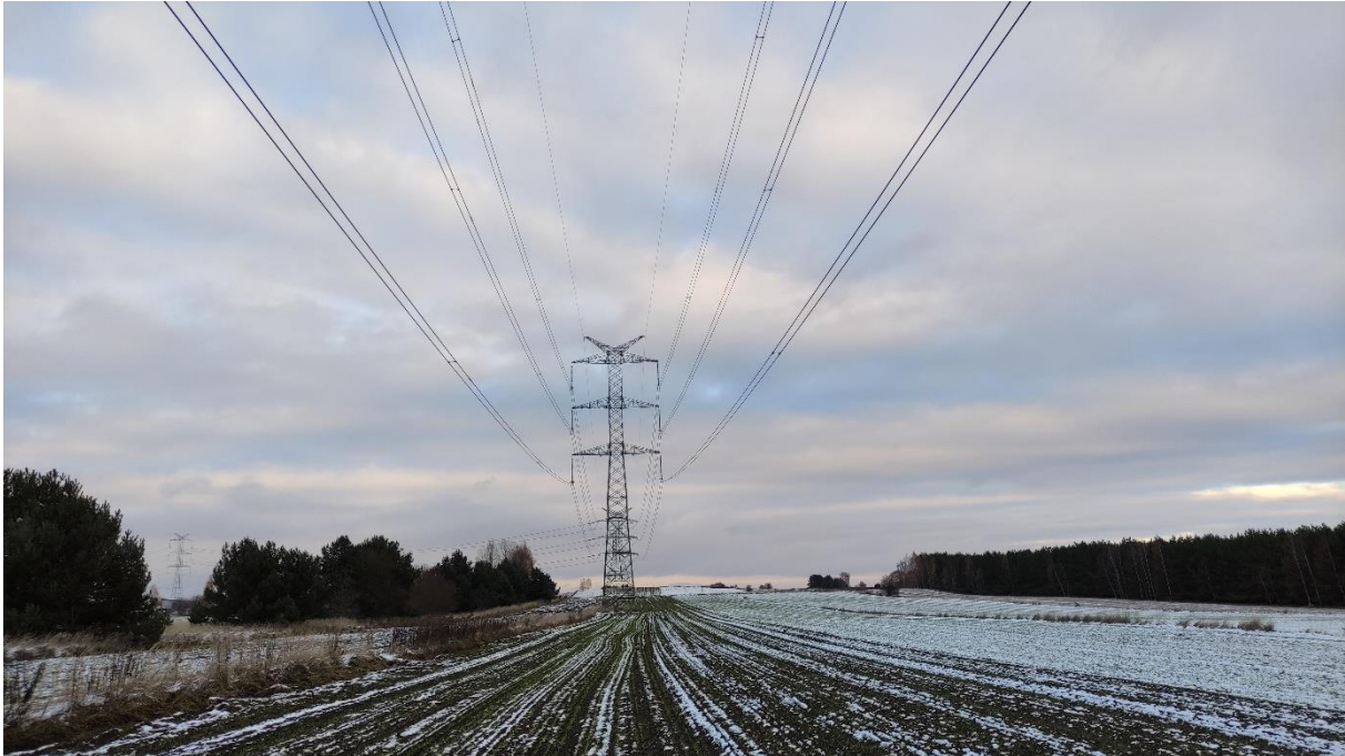
Zdjęcie nr 15. Dwutorowa Napowietrzna Linia Elektroenergetyczna 400 kV relacji Dobrzeń - Trębaczew i Trębaczew - Joachimów – widok fragmentu obiektu.
