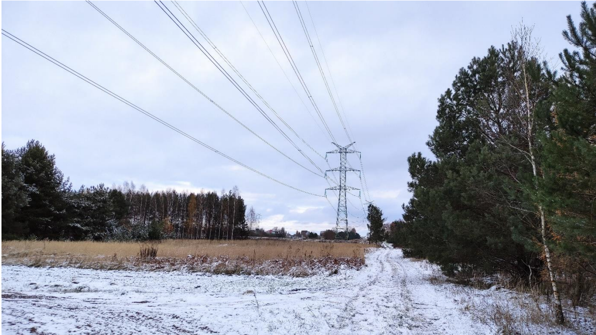
Zdjęcie nr 13. Dwutorowa Napowietrzna Linia Elektroenergetyczna 400 kV relacji Dobrzeń - Trębaczew i Trębaczew - Joachimów – widok fragmentu obiektu.
