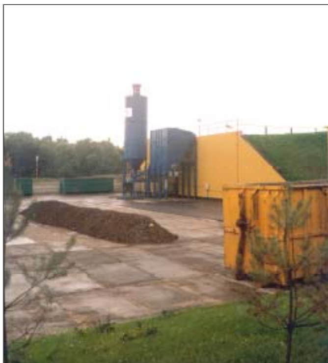
Rys. 3.1.3.1. Instalacja do sanitacji osadów ściekowych spółki KOMART z Knuruwa
